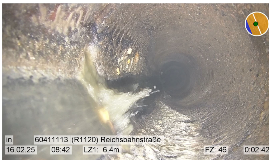
Foto 3: Grundwasserzufluss im Sohlbereich (Stat. +6,4 m) in der Haltung 1113 (DN 300) im Bollweg
