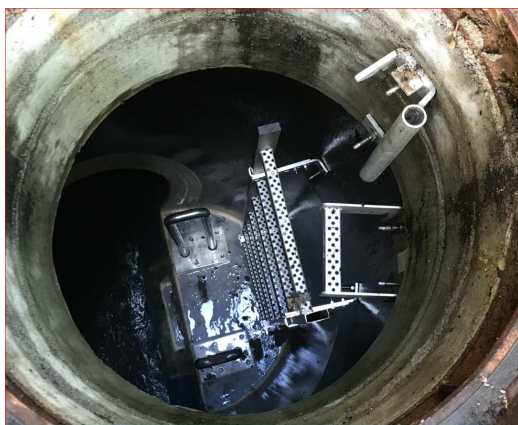
Abb.9: Kombination Steigleiter und Steigeisen (beide Edelstahl) mit Vollauskleidung und Steckhülse für Einstiegshilfe
