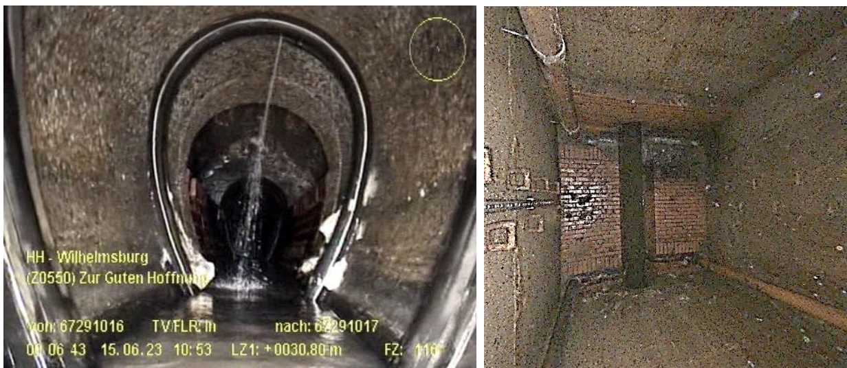
Abbildung 1: (links) Beispielbild mit Inkrustation, schießendem Wassereintritt im Bereich der AMEX-Manschette; (rechts) Beispielbild Betonschacht mit gemauertem Gerinne und innenliegender Anschlussleitung
