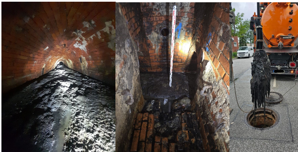
Abbildung 1: Zustand vor Sielreinigung
